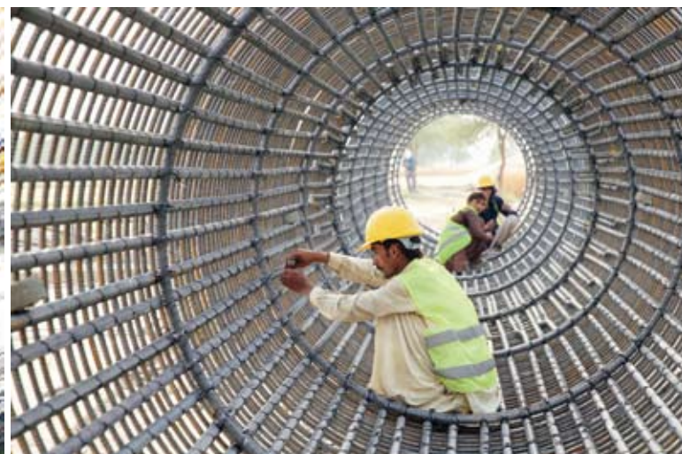
2017年4月21日,巴基斯坦工人在白沙瓦至卡拉奇高速公路(木尔坦至苏库尔段)的一处工地施工。由中国建筑股份有限公司承建的白沙瓦至卡拉奇高速公路(木尔坦至苏库尔段)全长392公里,是中巴经济走廊最大的交通基础设施项目。 摄影 刘天/新华社
