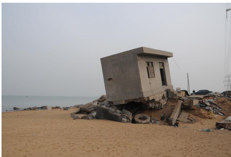
图 21 龙口岸边建筑物损毁
