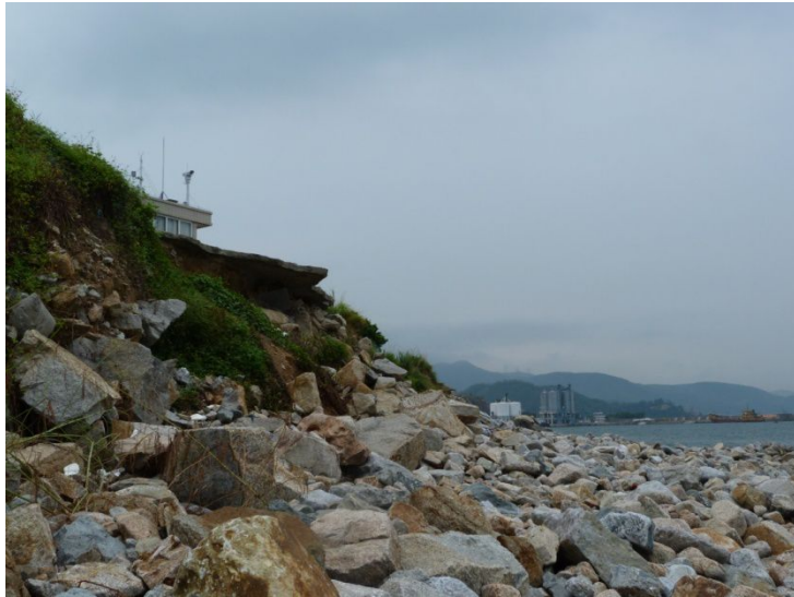
图 30 深圳惠深沿海高速公路土洋收费站岸段海岸侵蚀
